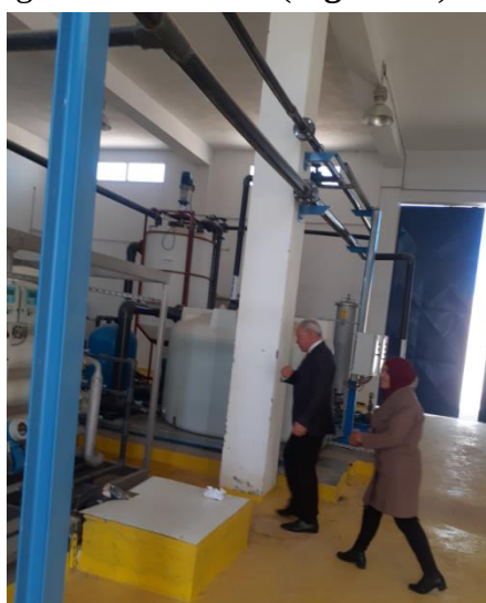
Figure 10. Station de traitement d'eau dans la délégation de Hezoua
