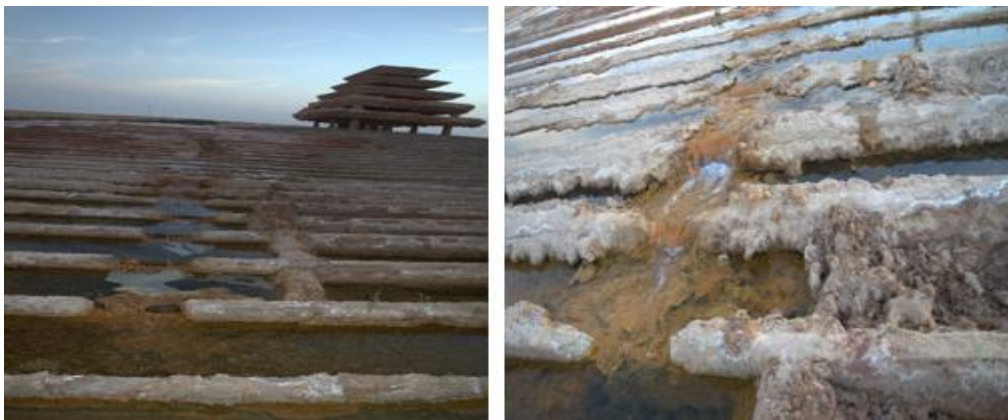
Figure 16 : Fissures au niveau des Seguias du refroidisseur
