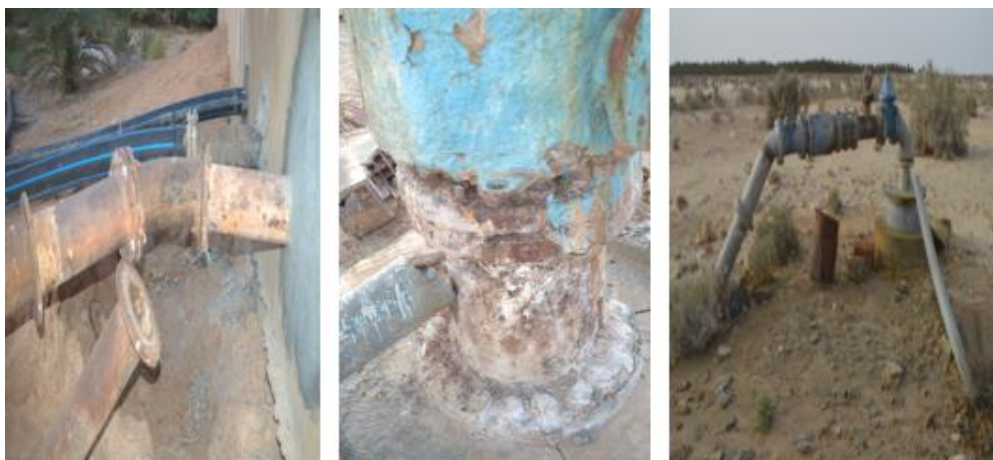
Figure 17 : Conduites d'eau en mauvais état induisant la perte d'eau
