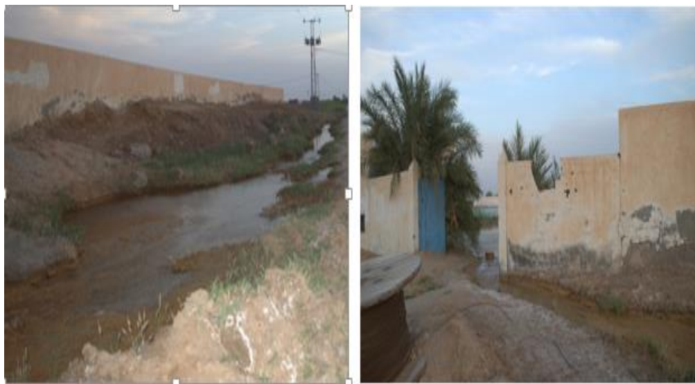
Figure 13 : Conduites d'eau stagnées au niveau de Mzara CI
