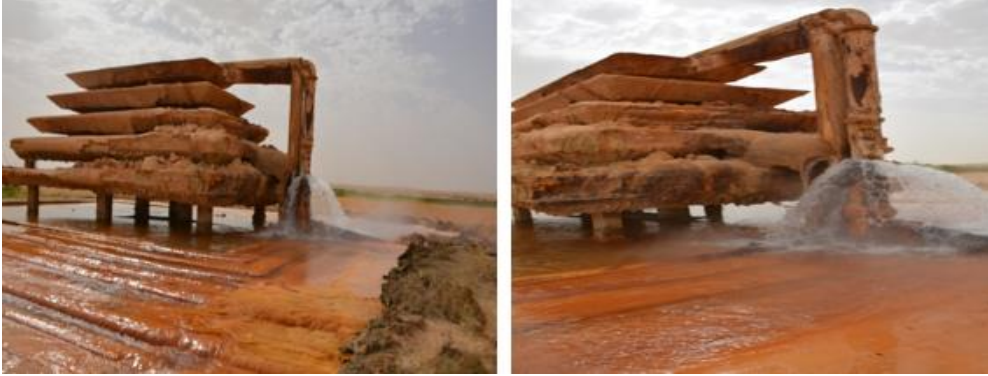
Figure 15 : Perte de l'eau chaude du refroidisseur
