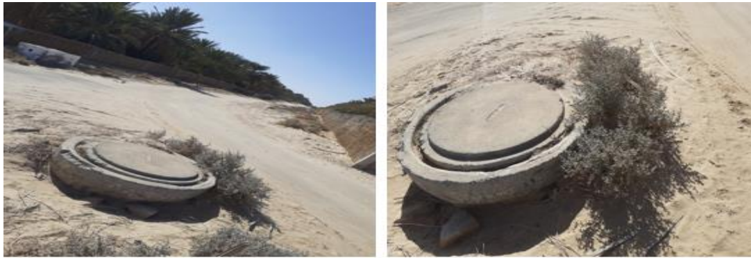
Figure 24 : Drainage souterrain à Hezoua3
