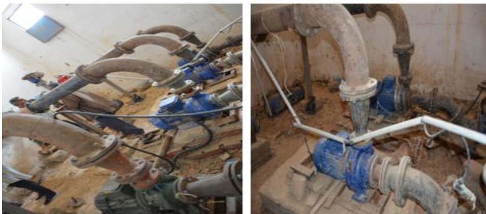
Figure 30 : Etat de pompage de forage à Mzara CI
