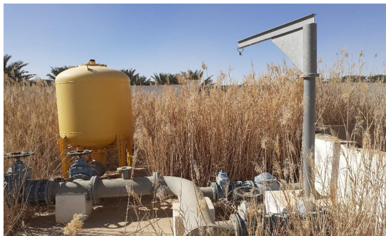
Figure 27 : Etat de station de pompage de Hezoua3
